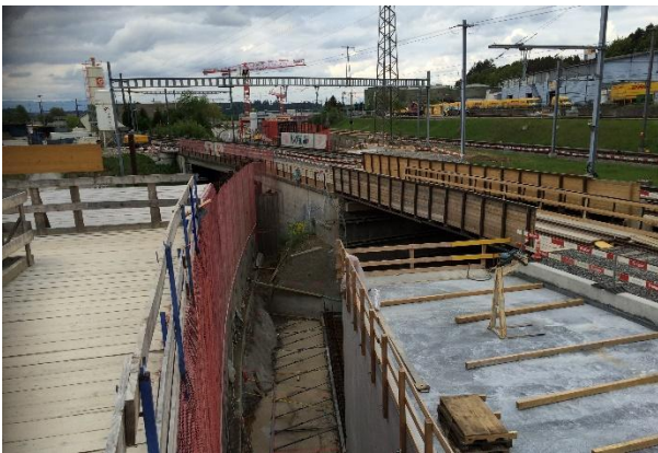
links Schutztunnel RBS, rechts erste Etappe Tagbautunnel und Hilfsbrücken für 2. Etappe, dahinter best. Unterführung
